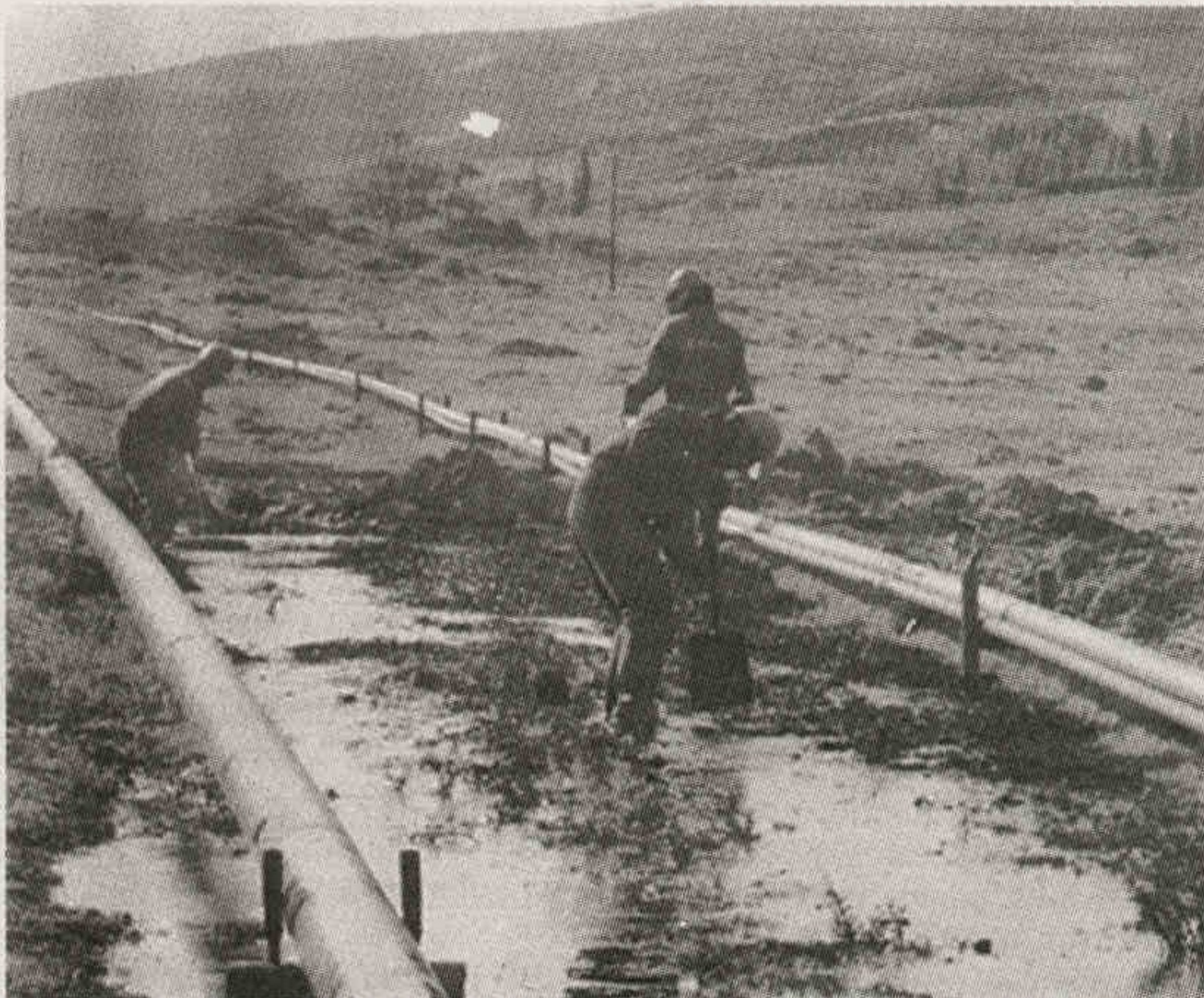
EL DERRAME FUE EN LA ZONA DE MANANTIALES BEHR.
